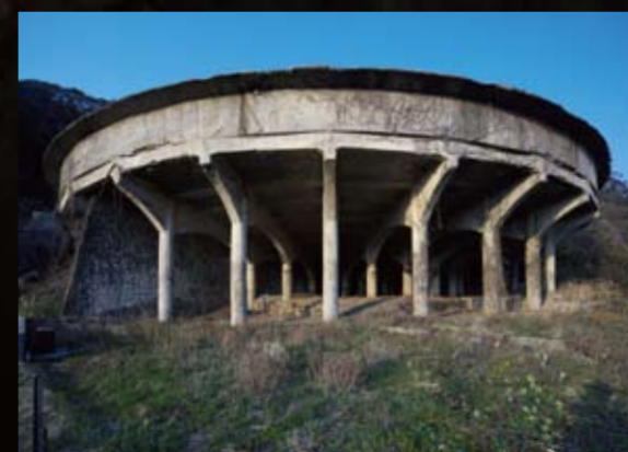
シッケナー 直径50mの鉄筋コンクリート製で昭和13(1938)年頃からの金の増産体制時に建設された。泥状の鉱物を鉱物と水に分離する施設。
